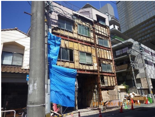
地震の被害を受けた建物(内部に吹付有り)
