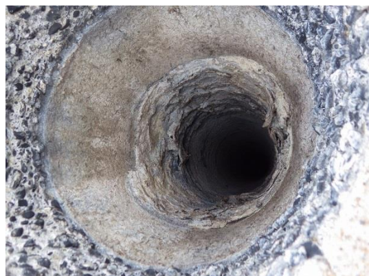
劣化した煙突断熱材(ニューカポスタック)
